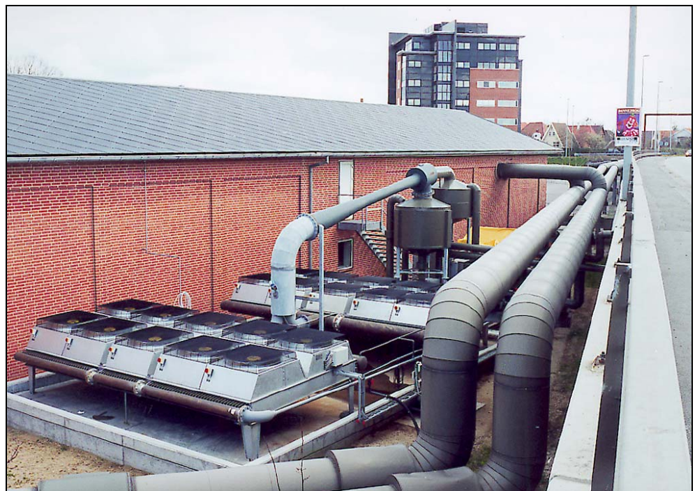
Figur 2-1: Foto af ejektorkøleanlægget hos Herning Kommunale Værker. Anlægget forsynes med varme fra fjernvarmerørene der ses til højre - i baggrunden ses administrationsbygningen
