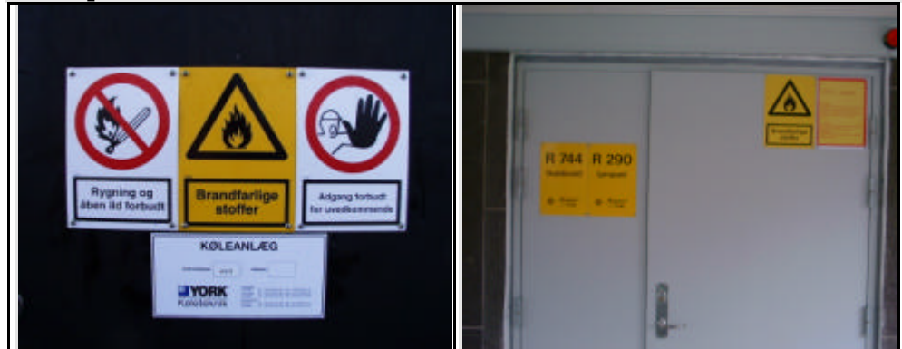
Mærkning af dør til maskinrum med kulbrintekølemidler.
