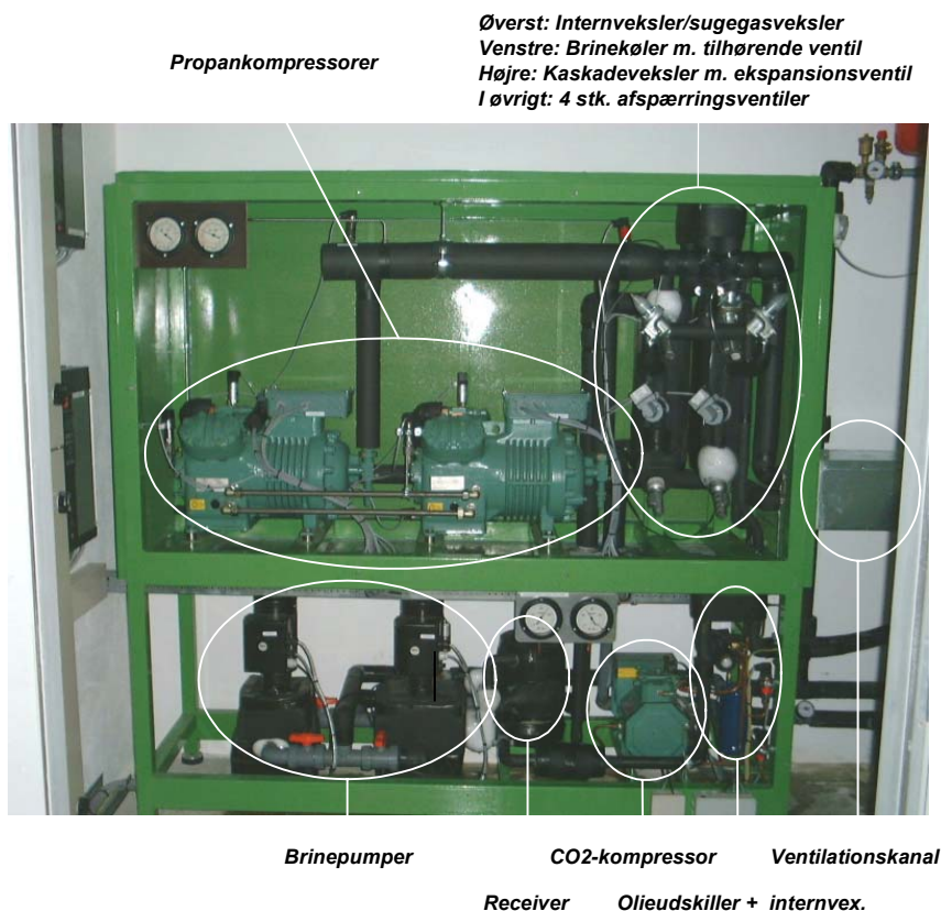
Figur 2: Billede af kompressorstativ
