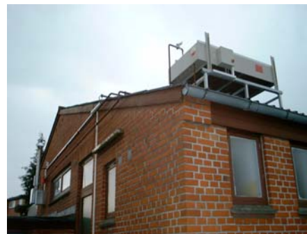
Figur 3: Den luftkølede kondensator placeret på taget.
