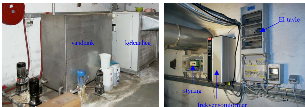
Figur 13: Billede af vandkøleanlæg og den nye styring til højre (case 3).
