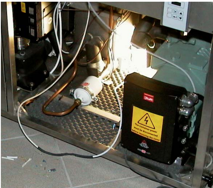
Figur 5.3.1: Billede af indvendig del af varmepumpe – til højre ses frekvensomformer monteret på kompressoren
