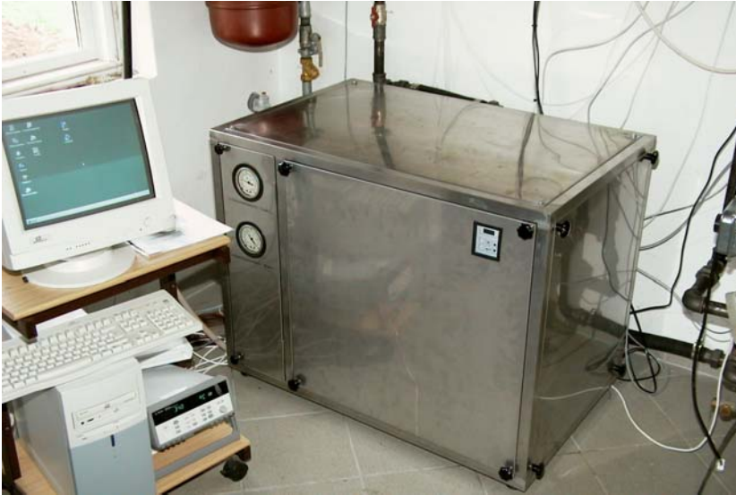
Billede 1.2.1: Varmepumpe, PC og dataopsamlingsudstyr opstillet indendørs i bryggers
